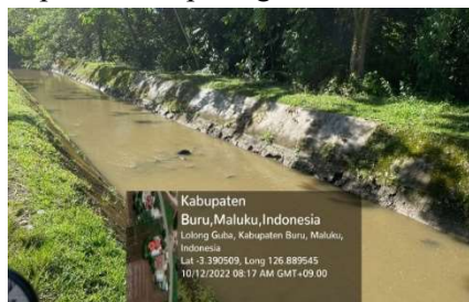
Gambar 1. Dokumentasi kondisi saluran lining rusak
