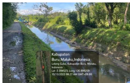
Gambar 2. Dokumentasi kondisi terjadi penumpukan sedimen
